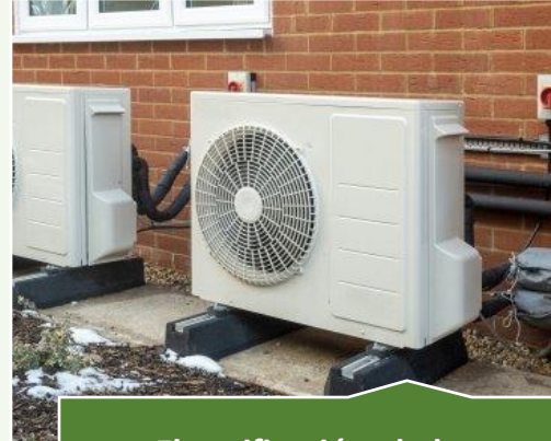
Electrificación de la calefacción
