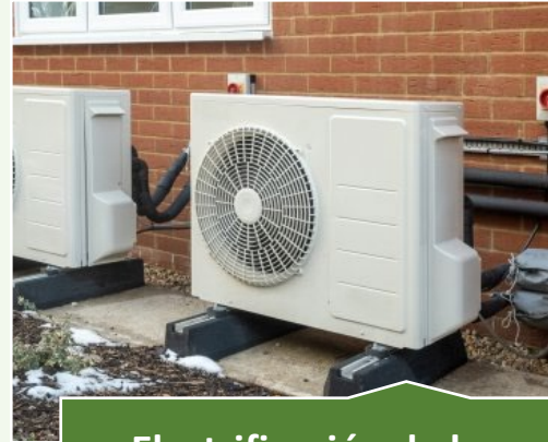
Electrificación de la calefacción
